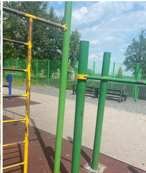
На спортивных снарядах следы коррозии
